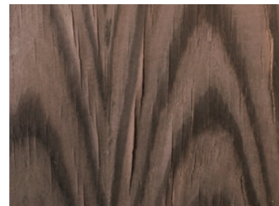
塗料の拭き取り不足による表面割れ
